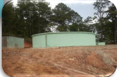
TANQUE DE ALMACENAMIENTO
