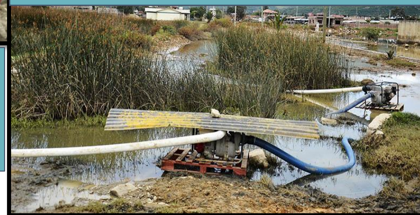
Bombeo de AR. en la Maica C.
