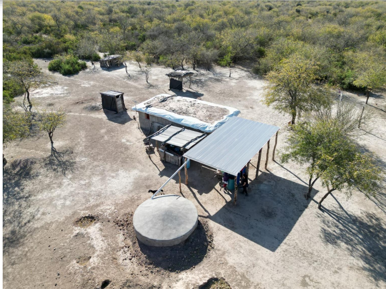
Sistema de captación de agua de lluvia en Copo - Santiago del Estero - ISF Ar.
