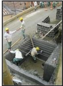
Cajas para válvulas reguladoras de presión
